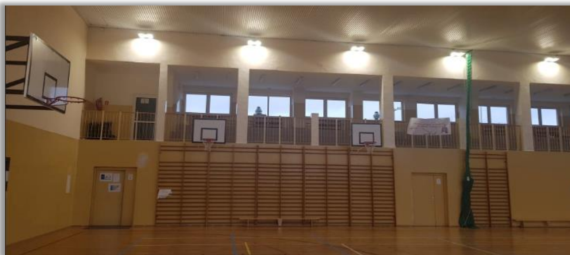
Fot. 33. Oświetlenie hali przy Szkole Podstawowej w Gaworzycach
